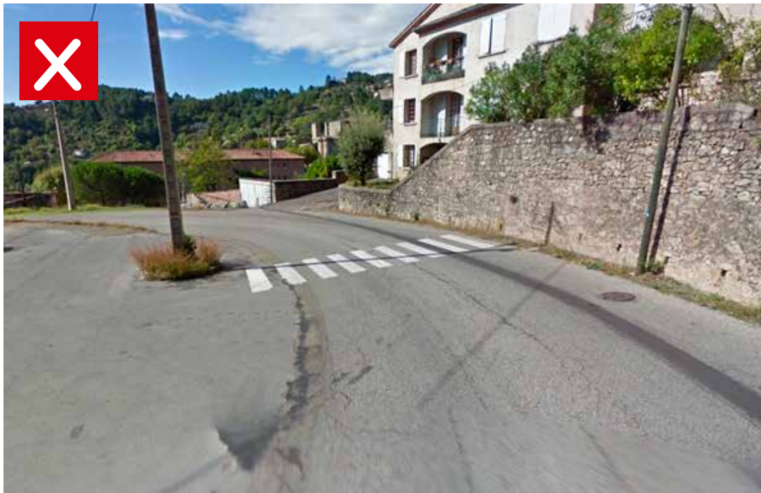
Passage piéton en courbe. Absence de cheminements latéraux.
