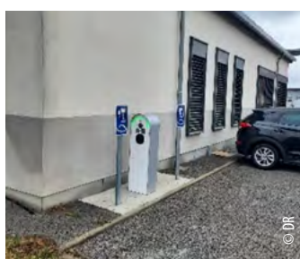
Borne de recharge centre des routes et des forestiers-sapeurs à Montréol
